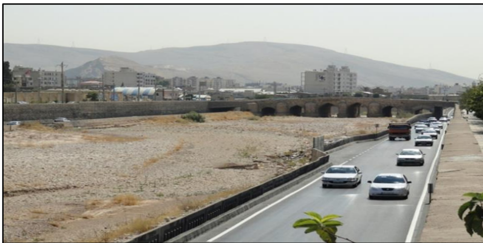
شکل ۲: ابعاد و ارتفاع نامناسب پل‌ها و احداث کنارگذر در بستر رودخانه برای حمل و نقل عمومی.
