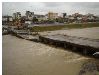
شکل (۱) سیلابی شدن رودخانه چشمه کیله و تخریب پل جانبازان (مهر ۱۳۹۴)
